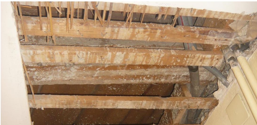
Sondagen, Deckenfreilegungen und Berechnungen der Bodennutzlasten haben bestätigt, dass die Tragkraft der Balken mit grossen Spannweiten ungenügend ist.
