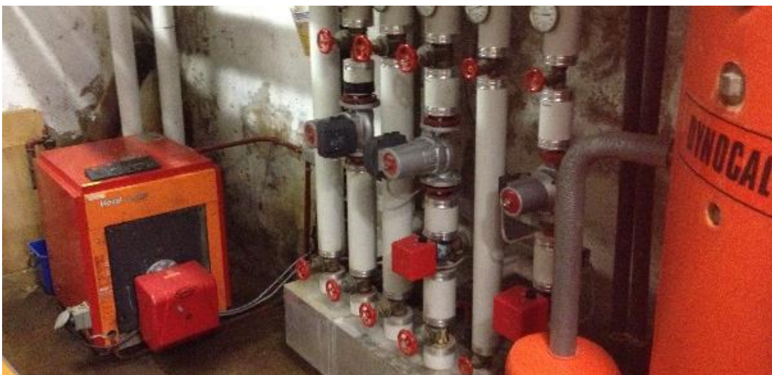
Die Heizungsanlage von 1974 erfüllt die Schadstoffgrenzwerte nicht mehr und muss ersetzt werden. Die neue Anlage soll mit erneuerbaren Energieträgern (Holzpellets) betrieben werden.
