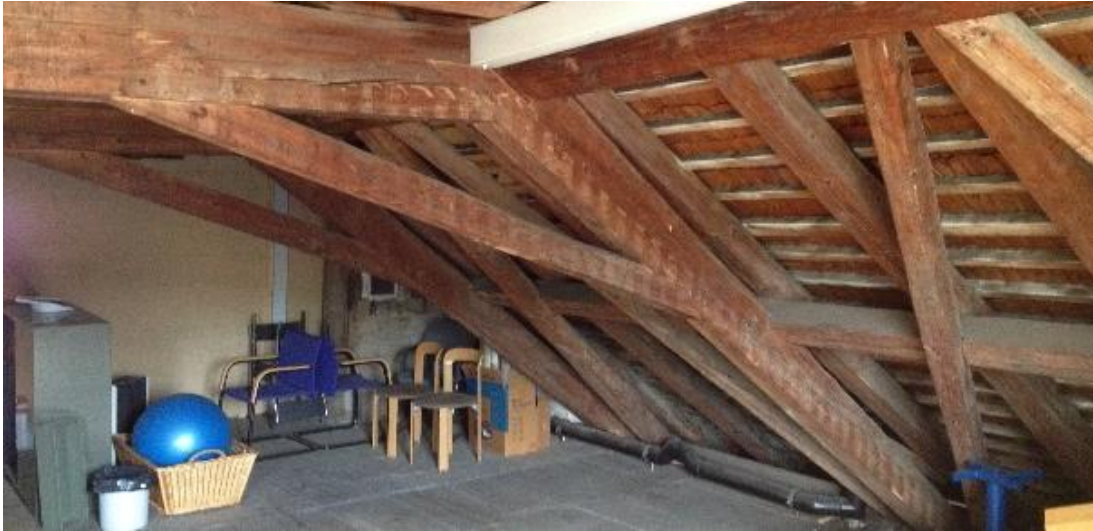
Das Dachgeschoss ist zur Hälfte noch komplett ungedämmt und konnte bisher nur als Lagerraum verwendet werden.
