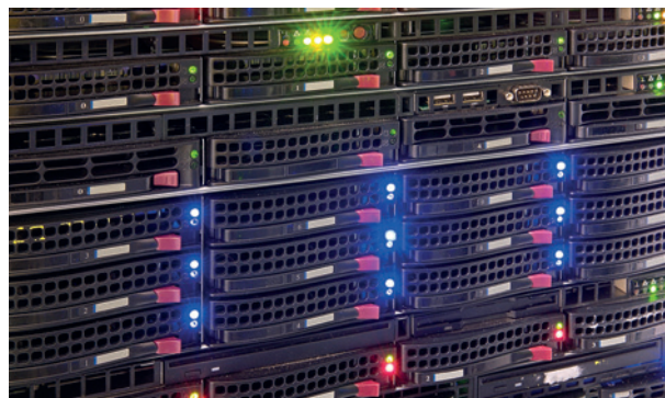
Die Informatikumgebung der Gemeindeverwaltung wird neu in einem Rechenzentrum betrieben (Symbolbild).
