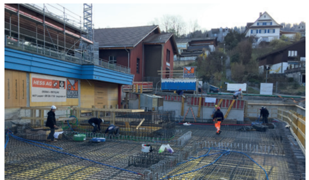
Unter dieser Betondecke befinden sich die neue Technikzentrale des Hallenbads und des Wärmeverbunds.
