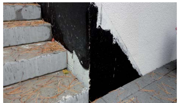
Befund vom Gemeindeammannamt: Fehlender Verputz bei einem Treppenabgang.
