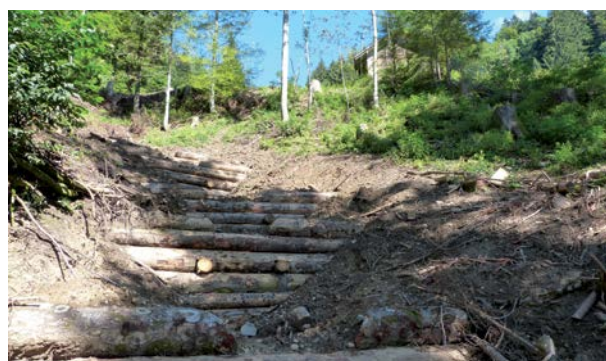
Rundholzsperrern verbessern am Fälmisbach die Hochwassersicherheit.
