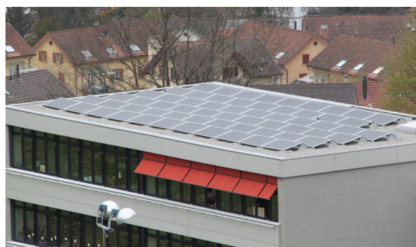
Eines der drei Schulhausdächer Neuwies mit der neuen Photovoltaikanlage.
