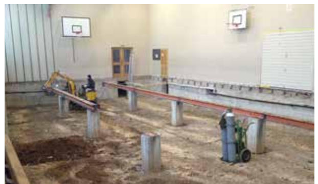
Die Turnhalle Burg, nachdem der schwebende Boden entfernt werden musste. Die Sanierungsplanung läuft.
