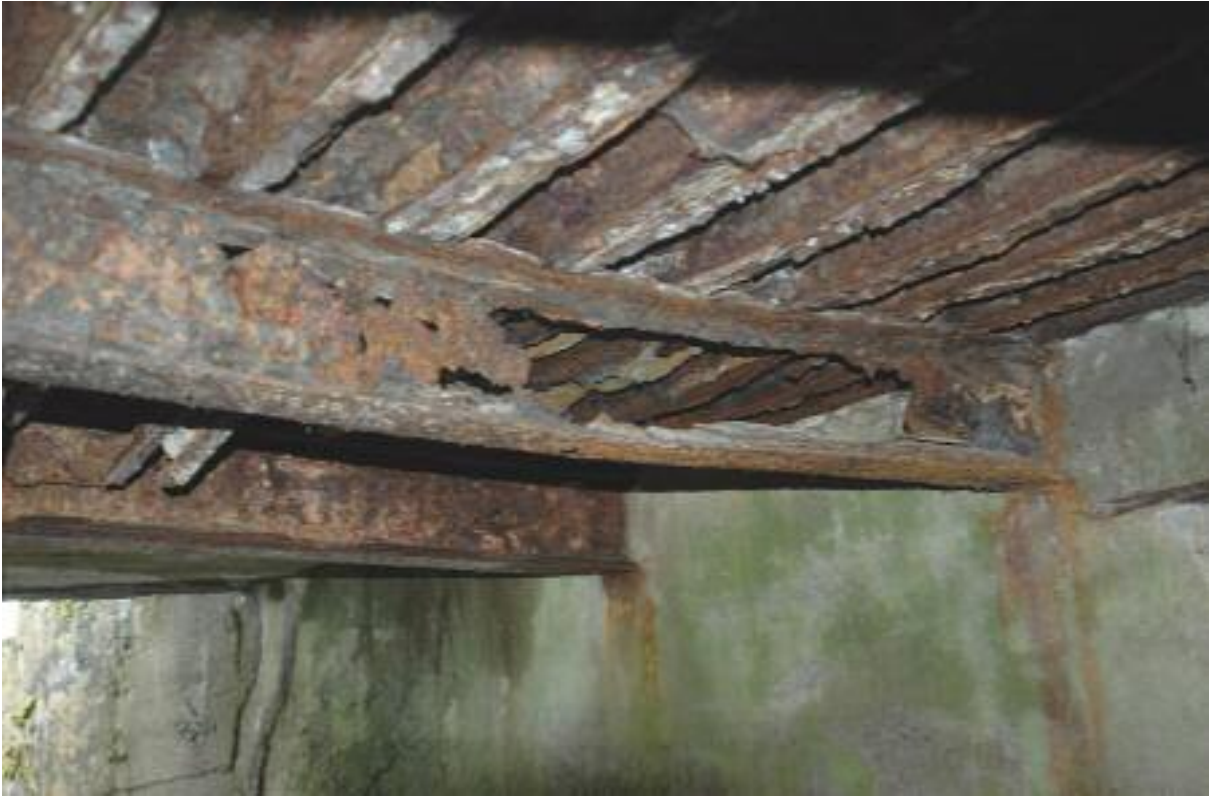
Foto: Instabile Brücke im Neuthal, komplett durchgerostete Stahlträger
