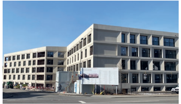
Das «Alterszentrum Rosenthal», eines der grössten Bauprojekte der letzten Jahre, wurde im Rohbau fertiggestellt.
