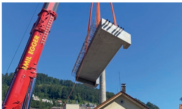
Die 75 Tonnen schwere Brückenplatte schwebte in luftiger Höhe, bevor sie millimetergenau «eingehoben» wurde.
